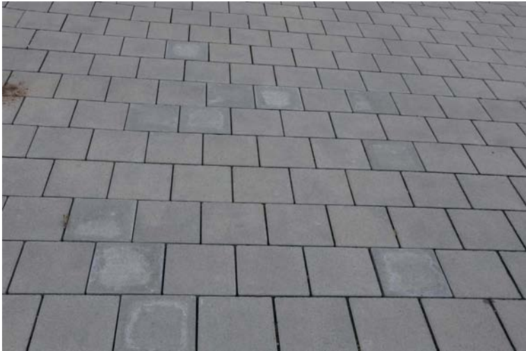
Bild 4: Deutlich sichtbar: die bräunlich-gelben Verfärbungen sowie auch die vorhandenen Ausblühungen auf bereits ausgetauschten Pflastersteinen (Quelle: Christine Andres)
